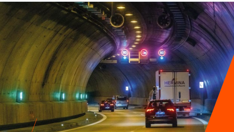
A93, Tunnel Pfaffenstein: Live-Bilder zur ständigen Überwachung und zum Eingriff bei Gefahrensituationen.
